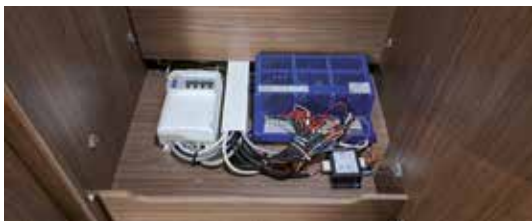
Die Elektrozentrale mit den 230 und 12 Volt Sicherungen ist im Kleiderschrank untergebracht
