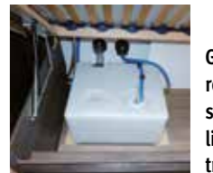
Gut erreichbarer Frischwassertank in der linken Betttruhe
