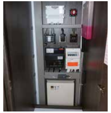
Stromzentralen 230 und 12 Volt sowie die iNet Box befinden sich perfekt zugänglich im Kleiderschrank
